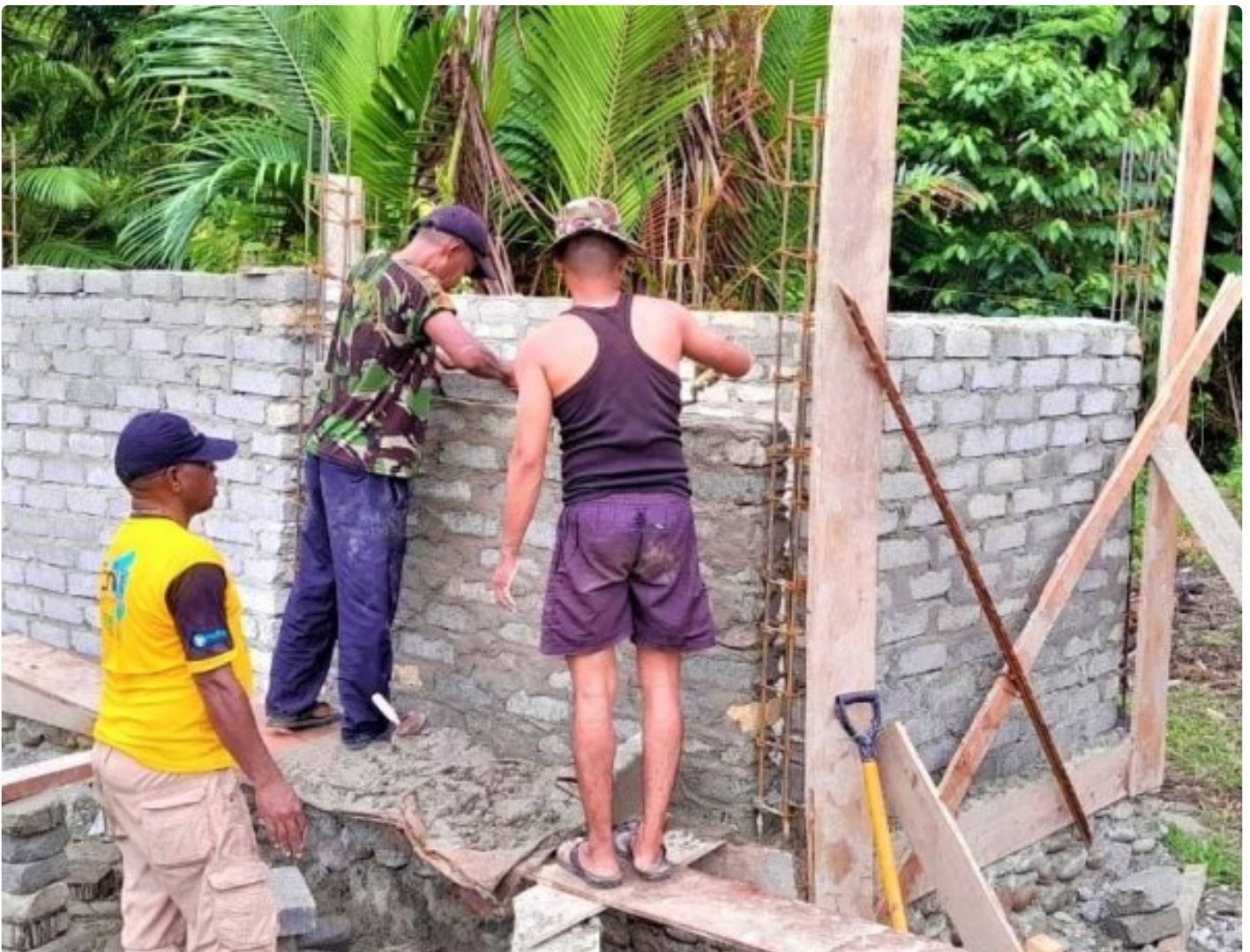
Satgas TMMD Saat Membuat Bak Penampungan Air Bersih Yntyk Warga Kampung Muara Nawa
